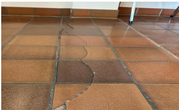
Setningsskade Støren skole 07.06.2024
