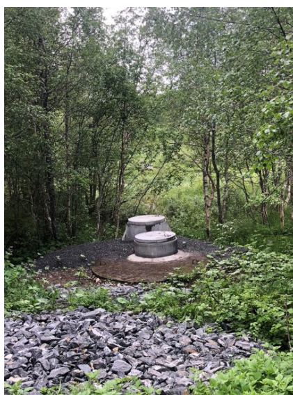
2-2. Brønnområdet til Ulvstuhaugen vassverk
