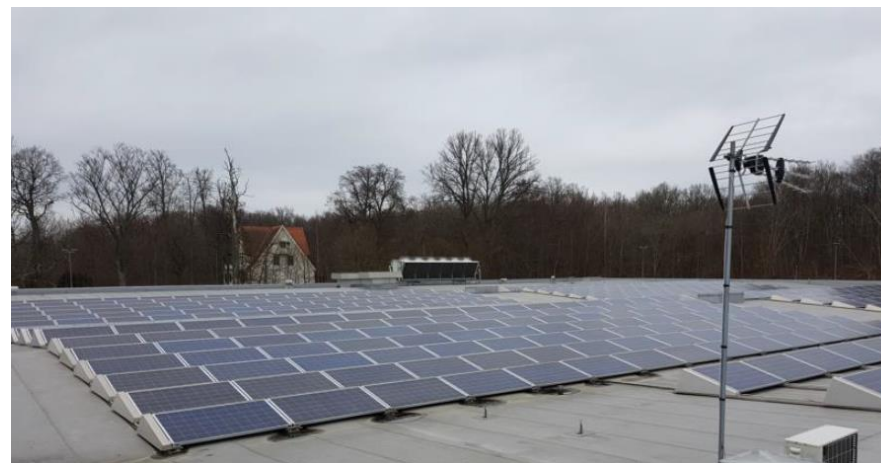
Solcellepanel montert på flatt tak på næringsbygg. Foto: Midt Energi AS.
