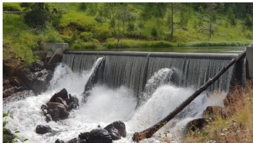
Råfossen kraftstasjon. Foto: Midt Energi AS.
