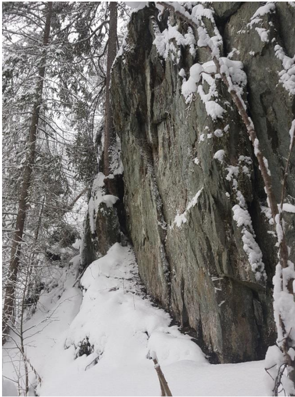
Figur 7 Parti av brattkanten som viser oppsprekking som kan danne flak-formede blokker.
