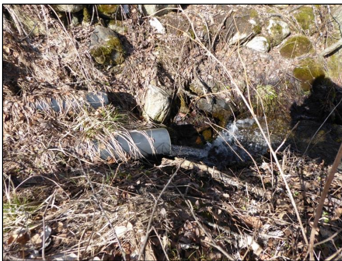
Figur 5: Vann fra VA-ledning som har utløp i øvre del av skråningen innenfor planområdet.
