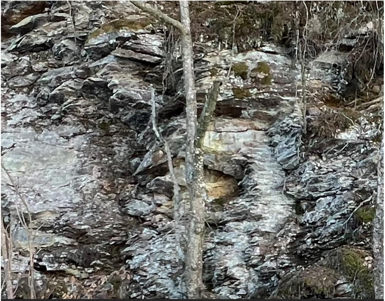
Figur 4 Oppsprukket og forvitret bergmasse ved planlagt fylkesvei i nord
