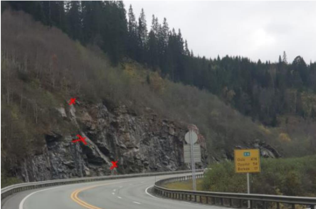
Figur 28 Sprekkeplan 4 med steilt fall ut av eksisterende skjæring ved profil ca. 34920. Bildet er tatt mot sørvest.
