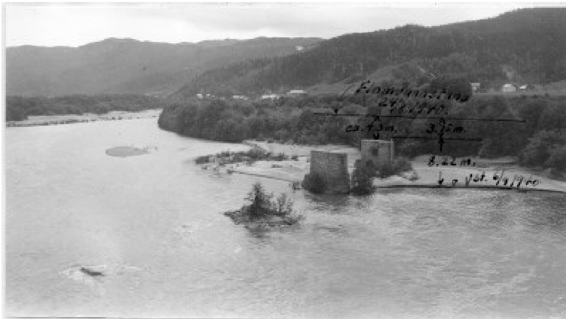
Figur 5-4: De gamle jernbanebrukar ved Gaulfoss. Vannstanden sto 4,3 m over brukarene. Foto: NVE/Olaf Strand.
