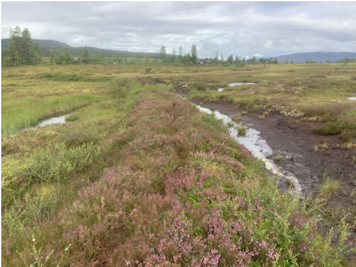
Figur 7. I forbindelse med etablering av sti til flere av hyttene ved sørenden av Holtsjøen er det også anlagt ei grøft. Stien går oppe på grøftekastet. Partivis er grøfta opp mot en meter dyp, og utgjør et betydelig inngrep i ellers intakte myrområder. Foto: Solfrid Helene Lien Langmo.
