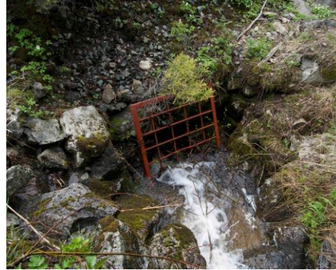
Figur 6.13.7: Viser gitterrist i bekk på nord side av jernbanelinjen. Bekk kommer ut i bilde under.
