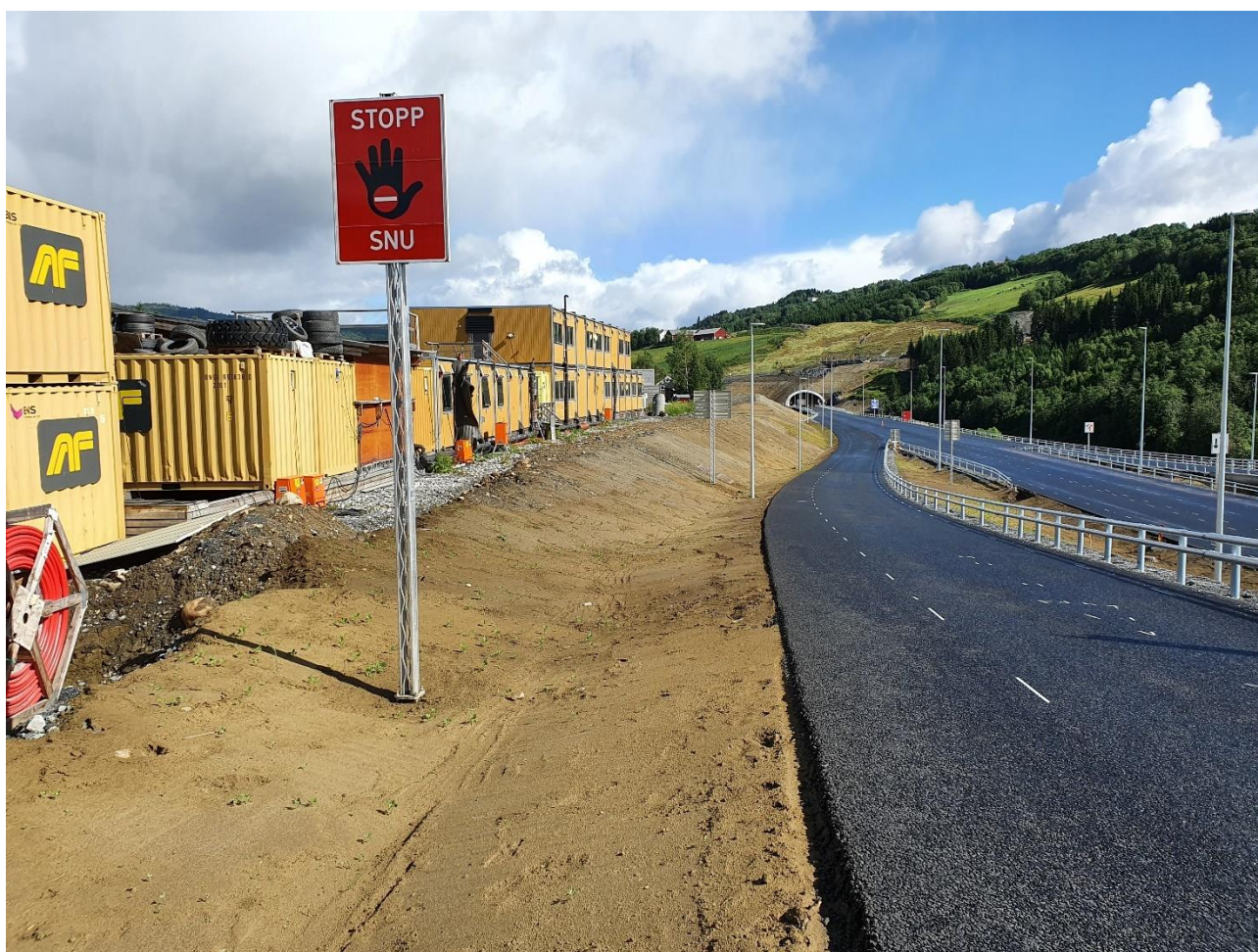
Figur 3: Bilde tatt mot nord fra retardasjonsrampen for avkjøring til Soknedal. Toppen av grøften man ser her er målt inn av oppmålingsingeniør, og tegnet inn i VAO-planen (dokument VAO_02). Den ser ut for å ha liten kapasitet mht. til vanntransport og er svært sårbar for erosjon.
