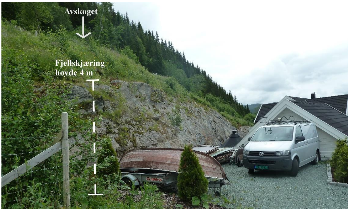
Figur 5.19: Usikret fjellskjæring tett innpå garasje og bolighus, med gards- og bruksnummer 3/268 for garasje og 3/260 for bolighus. Løsmassedekket ovenfor fjellskjæringen er svært tynt, anslagsvis ca. 15 cm, og like ovenfor ligger hogstfelt A. Bildet er tatt mot sør (Foto: Marte Bakka Stemland, 08.07.2015).
