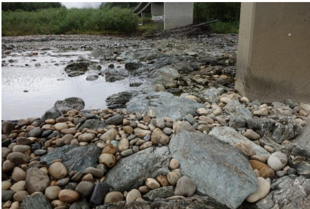
Figur 30. Midtre pila på dagens Gaula bru har endret elvas naturtilstand. Plastringstein skal forhindre undergraving ligger opp- og nedstrøms.
