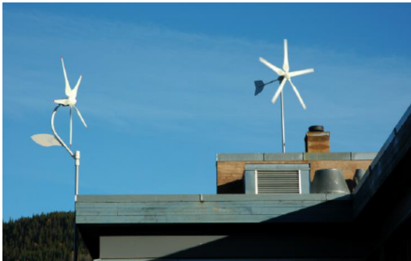
Små vindmøller montert på taket av (Midt Energi AS sine lokaler) næringsbygg i Støren sentrum.
