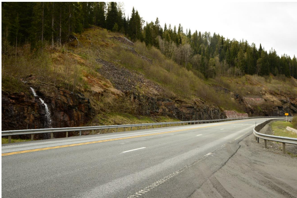
Figur 47: Bratt sideterreng. Bildet er tatt vest for profil 1350 mot stigende profilnummer. Bekkeløpet til venstre tilsvarer bekkeløp som krysser lokalvegen ved profil 1390. Tørrsteinsmur er vist i høyre del av bildet.
