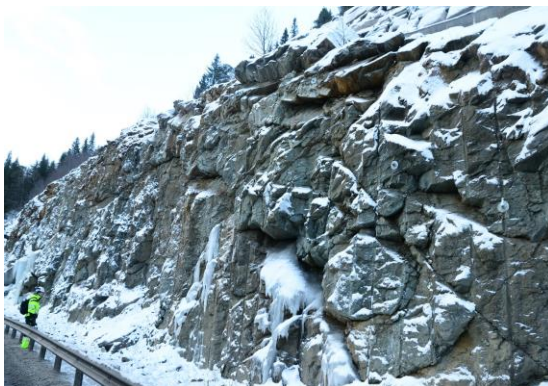
Figur 48: Skjæring i berg langs eksisterende E6 ved profil 1600-1700. Grovblokkig bergmasse med gjennomsettende sprekker og enkelte sleppeplan med fall ut mot vegbanen. Vannsig fra sprekke.
