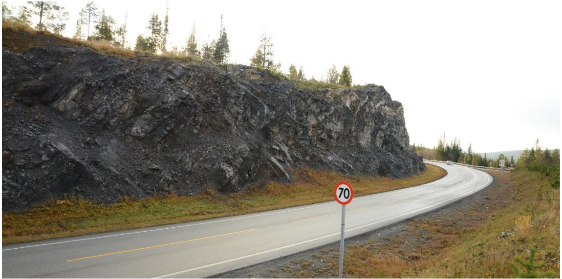
Figur 28: Skjæring i berg langs eksisterende E6 ved Storpynten, ca. 300-400 meter nord for ny trasé
